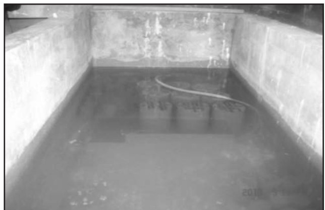
FIGURA N° 16 Tanque de agua (laboratorio)
